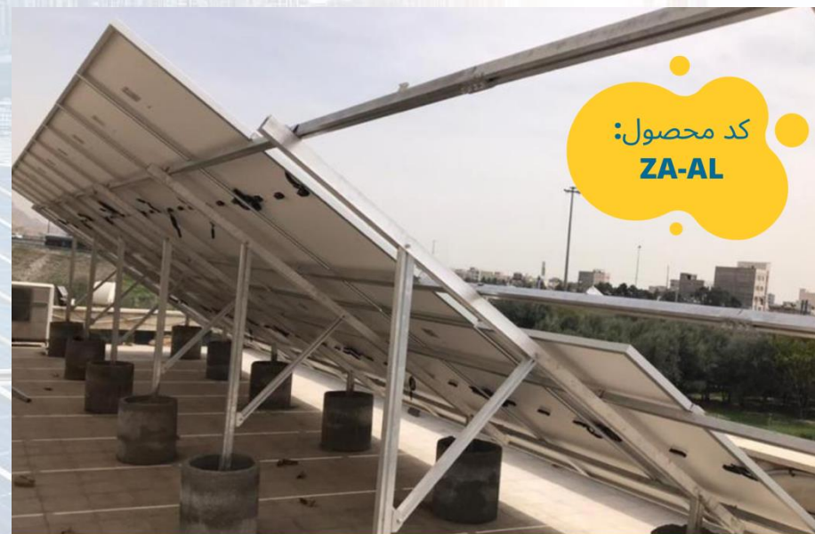
تیپ سازه : زاگرس (بتن ریزی در محل) Mehrafarin Sazeh Solar Pasargad
